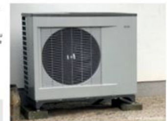
Abbildung: Wärmepumpe im Freibereich
